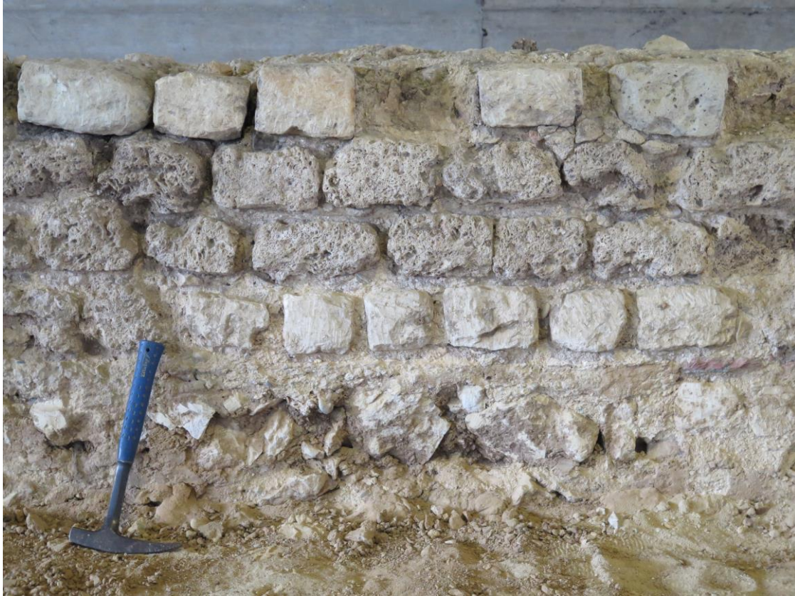
Fig.6. Stuk parement uit de zuidelijke muur van het badhuis: combinatie van blokjes gekapte Kunradersteen en gezaagde kalktuf, bovenop een ondermuur bestaande uit ruwe blokken Kunradersteen.
