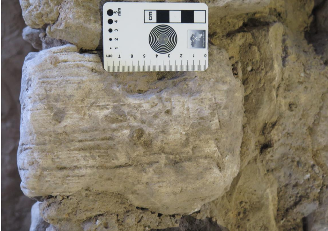
Fig.2. Detail van laminaties in een blok Kunradersteen uit een binnenmuur van het badhuis.
