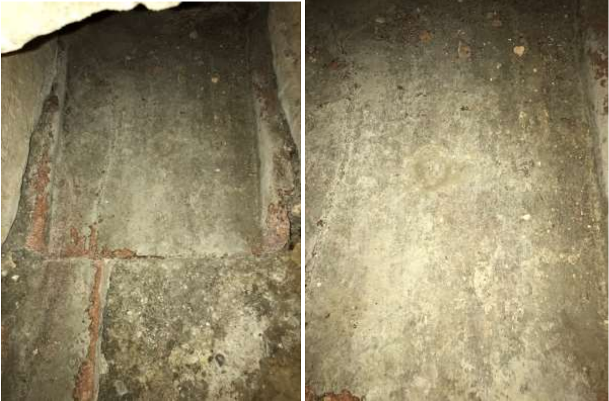
Figuur 102 Links: Goot bekleed met tegulae in kijkgat frigidarium – ruimte 14. Rechts: ronde indruk op de tegula.
