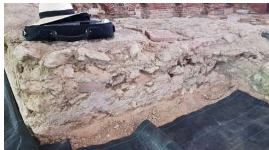
Afb. 2.25 Tepidarium , oostelijke deel van de noordelijke funderingsmuur waarvan het onderste deel rechtstreeks tegen het verticaal afgestoken bodemprofiel is aangebracht (foto: PANSA BV).
